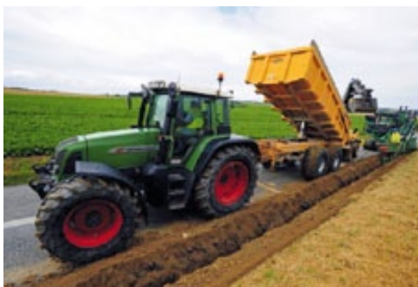
Enfouissement de ligne à Frémainville (Val-d'Oise) : creusement d'une tranchée et enfouissement de câbles à l'aide d'une trancheuse
